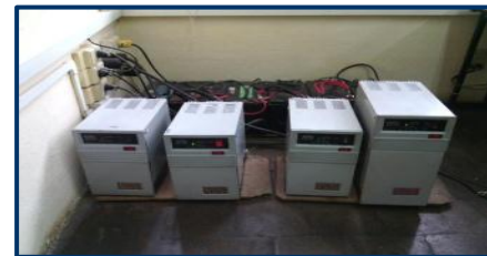
BANCO DE ENERGÍA REGULADA
