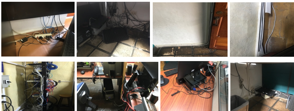
Figura 7. Seguridad en el cableado
